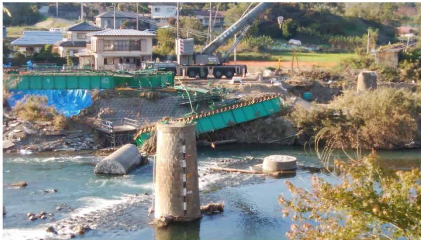
写真-1 流失した第六久慈川橋梁 (2019 年 11 月 10 日、当専攻教員撮影)
